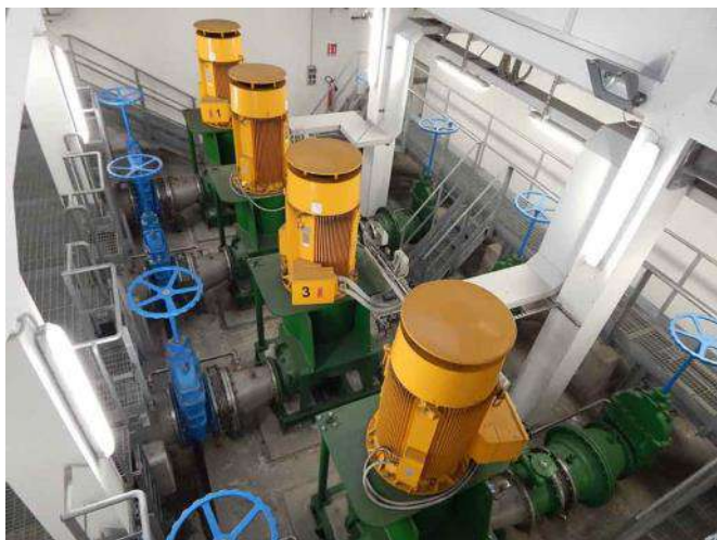
Fig. 98. Impianto della Centrale di pompaggio Padova.
