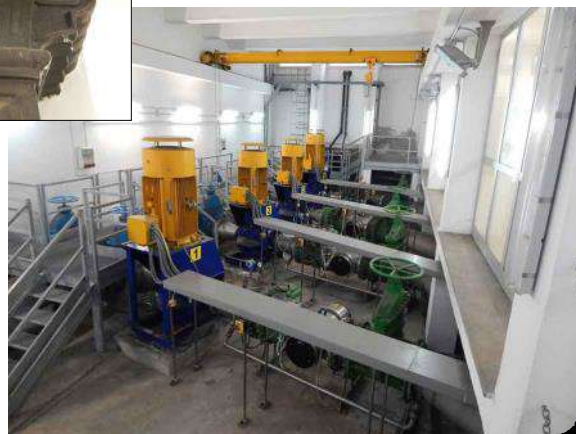
Fig. 58. Interno della Centrale di pompaggio Parco.
