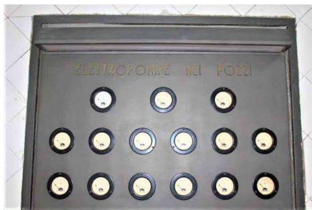
Fig. 53. Quadro d'epoca delle Elettropompe dei Pozzi.
